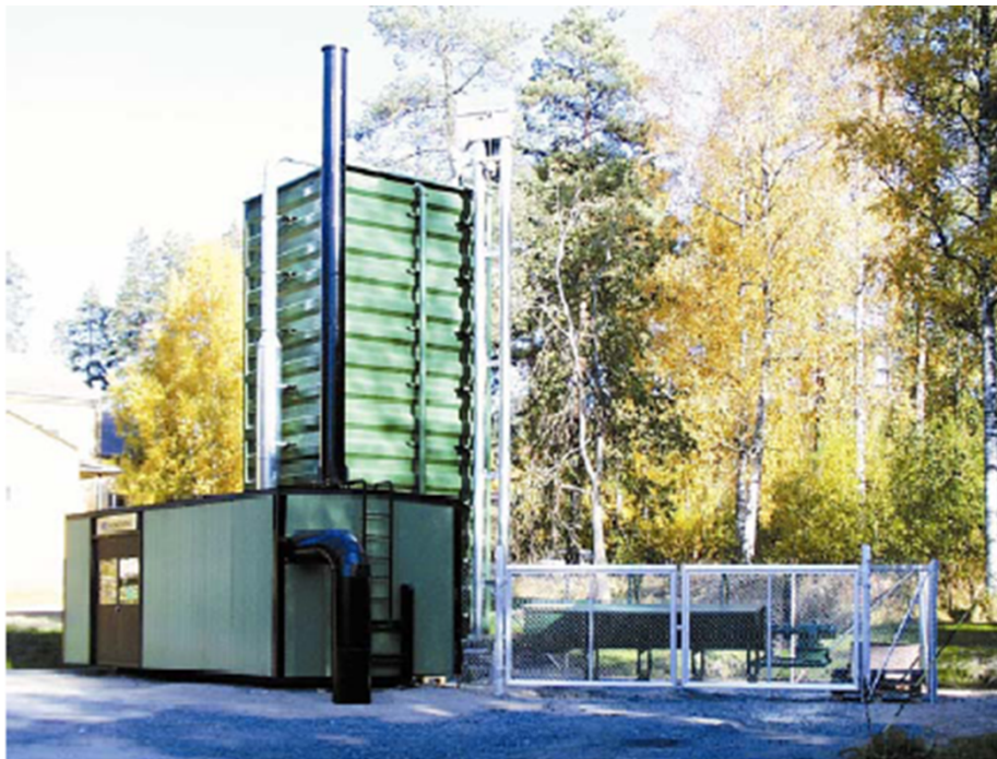
Granulu konteinertipa katlu māja
